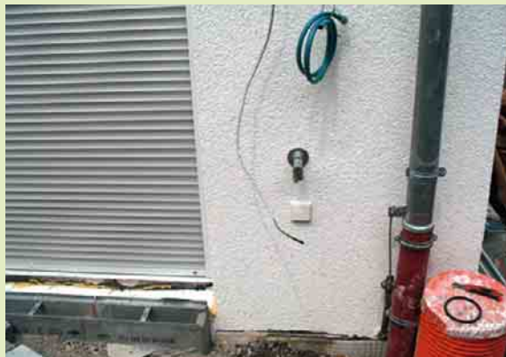
1 Vom Anfragenden vorgefundene Art der Installation einer Schuko-Steckdose (IP 44) im Außenbereich
